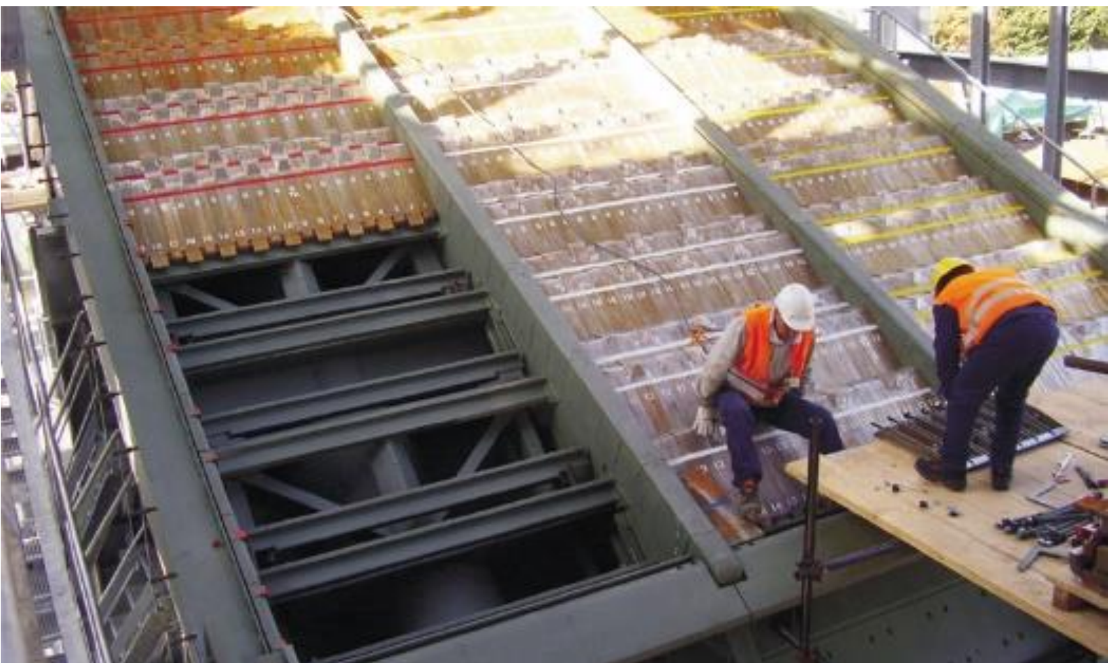
Montage eines Rückschub-Rostes Vario, mit freundlicher Genehmigung der Martin GmbH für Umwelt- und Energietechnik.
