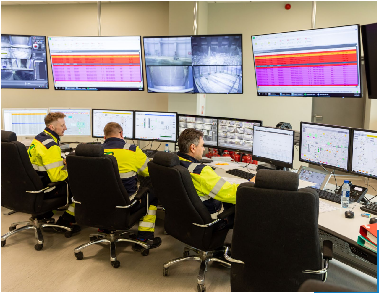
Control Room of the Kaunas cogeneration WtE plant, Lithuania. © Kauno kogeneracinė jėgainė
