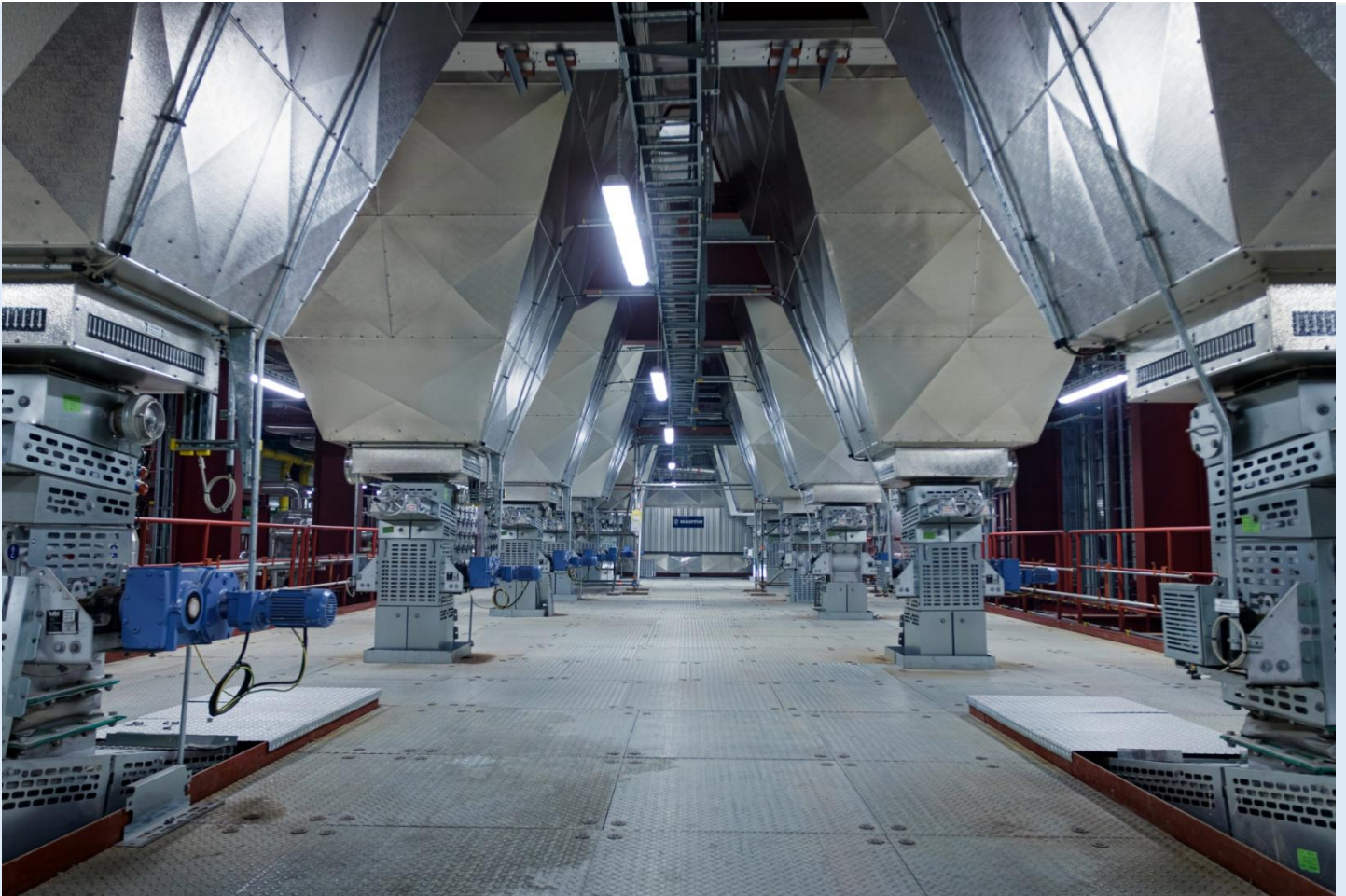
Boiler hopper at the Magdeburg-Rothensee WTE plant, with kind permission of MARTIN GmbH für Umwelt- und Energietechnik.
